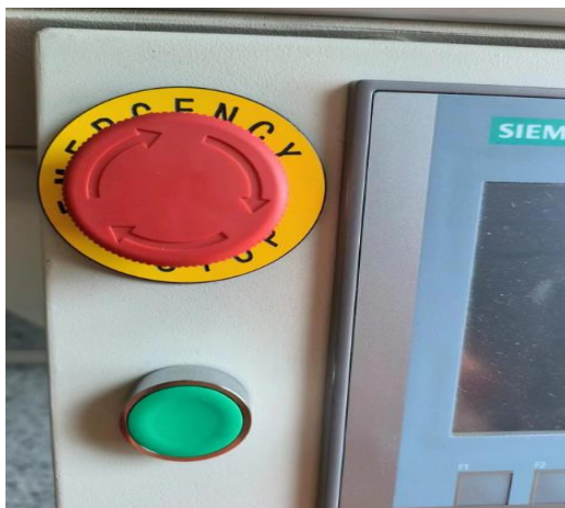
图 4-3 整流模块进线回路接通按钮
