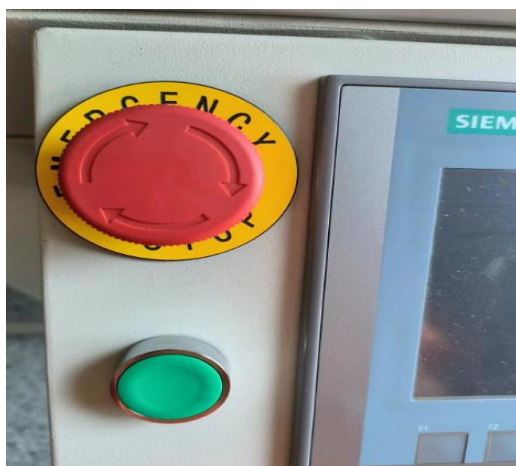
图 4-3 整流模块进线回路接通按钮
