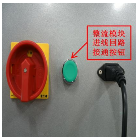
图 4-3 整流模块进线回路接通按钮
